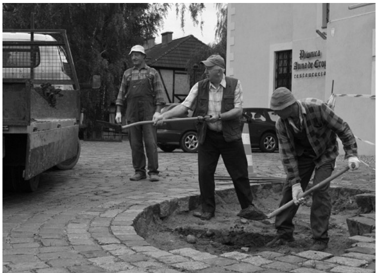
Słupsk, rok 2010. Wykop pod fundament pomnika Bogusława X. Pierwszą łopatę wbili w ziemię Jan Maziejuk (od lewej) i pracownik firmy „Morze”.
