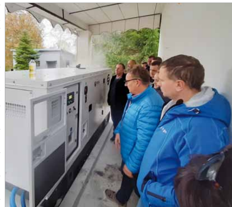
Agregaty pozwolą na funkcjonowanie domów pomocy społecznej na wypadek awarii prądu.
